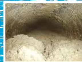
中で油が固まった下水道管
