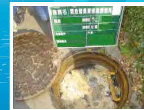
油が固まってふさがったマンホール
