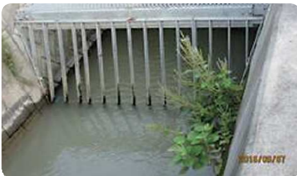
ごみを除去した後のスクリーンの様子
