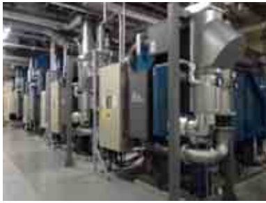
写真 7.1-35 冷温水発生器 (H28.6.14 撮影)
