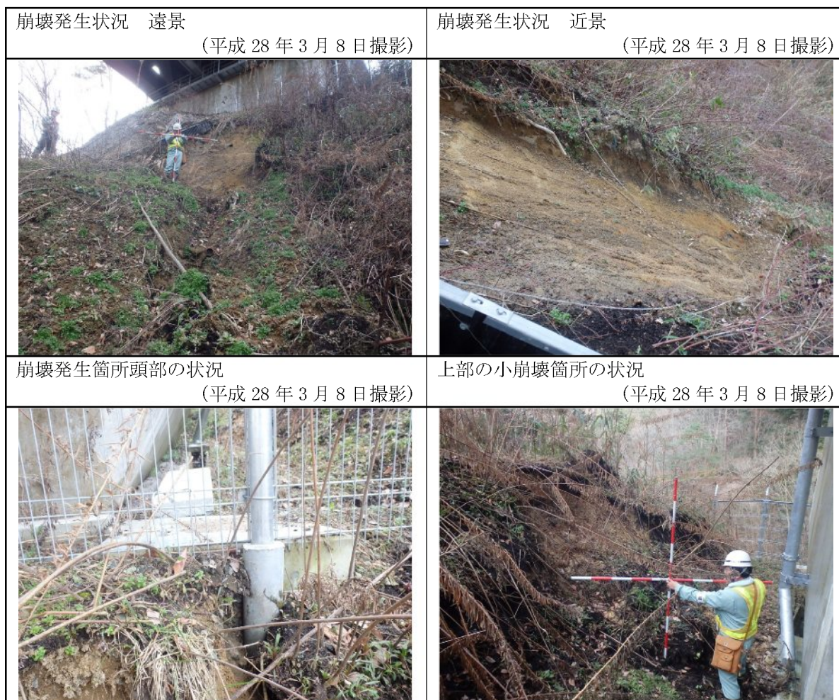
写真 6.1.1-6 左岸橋脚付近の表層崩壊箇所の状況 (平成 28 年 3 月)
