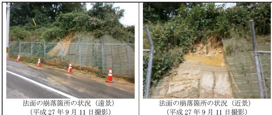
写真 6.2.3-1 出水による法面の崩落箇所
