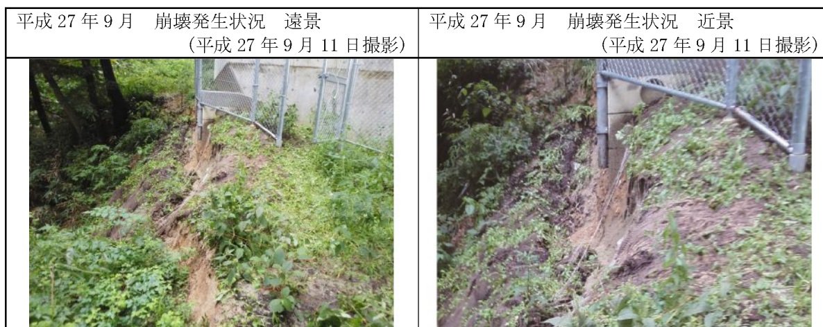
写真 6.1.1-5 右岸橋脚付近の再崩壊後の状況（平成 27 年 9 月）
