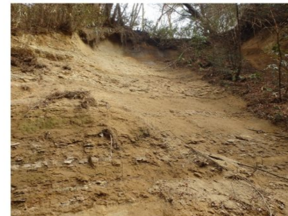
②右岸工事用地下端部の下 溪岸の状況 右岸斜面排水路より排水が行われているが、浸食等は生じていない。オーバーハングで不安定な地形だが H27.11.25 から新たな崩壊は発生していない。
