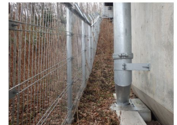
⑥左岸工事用地上流側面 前回調査(H27.11.25)から排水路周辺の斜面の法面植生工箇所の植生が発達し、溪谷への土砂流出を予防している。
