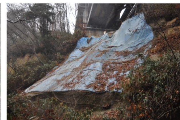
⑤左岸橋脚前面の状況 シートとネットで表層のガリー浸食 ※1 による土砂流出を防止している(H24.12.26 と変化なし)。
