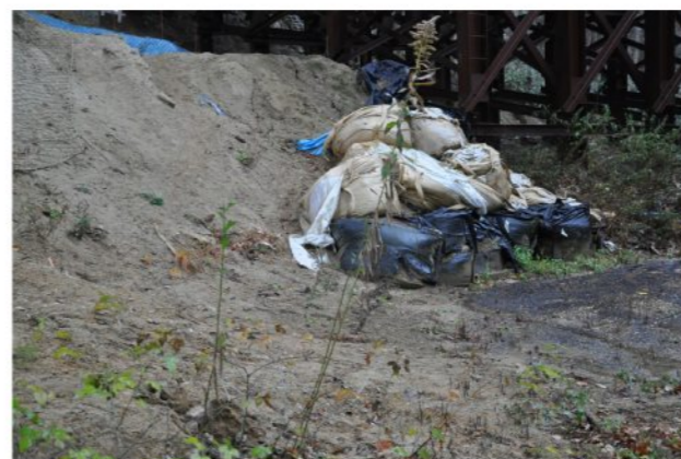
③右岸棧橋と橋脚周辺 地山表層は整形後に降雨でガリー浸食 ※1 され、一部表層土砂が流出したため、大型土嚢とシートによる処置を行い更なる土砂流出を防止している。シートがかかっていない部分は土砂流出していない部分である。
