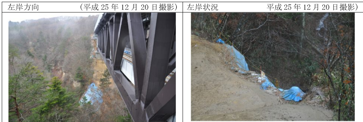
写真6.1.1-1 左岸 竜の口溪谷急斜面の状況
