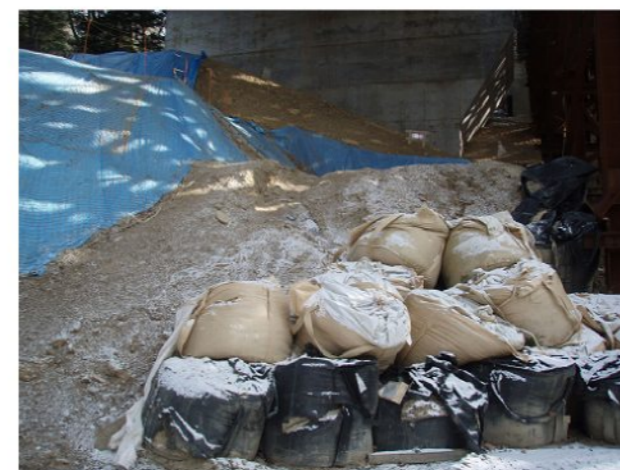
③右岸栈橋と橋脚周辺 地山表層は整形後に降雨でガリー浸食 ※1 され、一部表層土砂が流出したため、大型土嚢とシートによる処置を行い更なる土砂流出を防止している。シートがかかっていない部分は土砂流出していない部分である。
