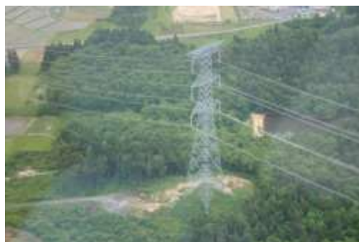
送電線を吊り下げている鉄塔
