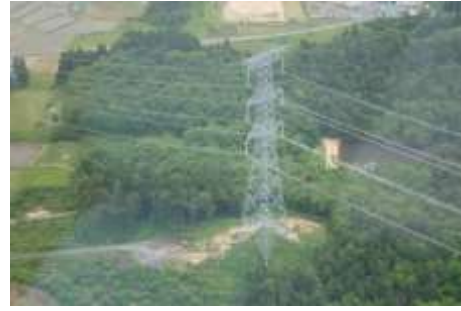
送電線を吊り下げている鉄塔
