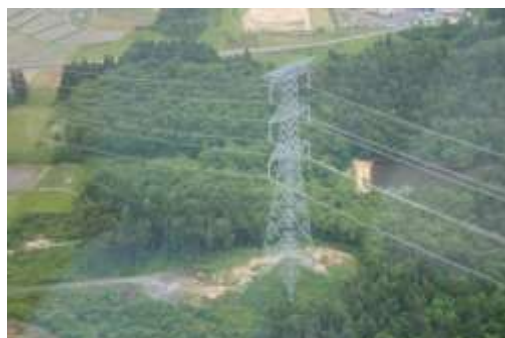
送電線を吊り下げている鉄塔
