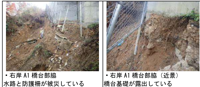
写真 4. 2. 3-3(1) 右岸 A1 橋台部の被災状況
