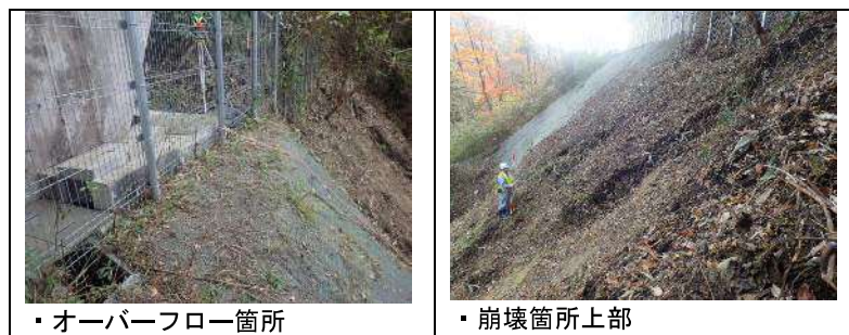
写真 4. 2. 3-4 (2) 左岸 P2 橋脚部の被災状況
