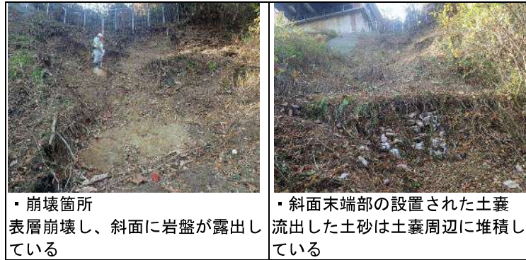
写真 4. 2. 3-4 (1) 左岸 P2 橋脚部の被災状況
