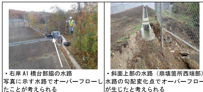
写真 4. 2. 3-3(2) 右岸 A1 橋台部の被災状況
