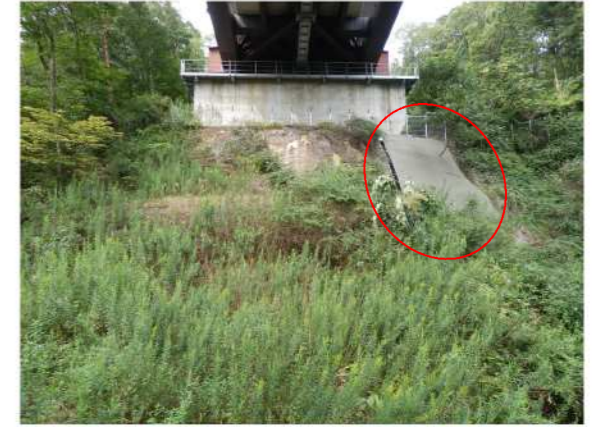
⑤左岸橋脚前面の状況 法面植生工箇所の植生が発達し、表層のガリー浸食 ※1 による土砂流出を防止している。斜面排水路脇の崩壊箇所についてすべり抑止杭の設置、盛土による復旧工事が行われた。
