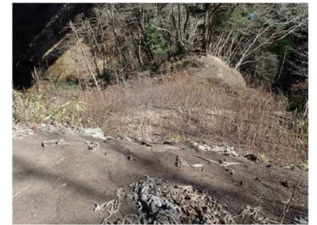
④左岸工事用地下端部 法面植生工箇所は枯れた植生が残存している。融雪に伴う新たな土砂の流出は認められない。(前回調査 H29.9.20 から変化無し)
