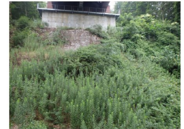
⑤ 左岸橋脚前面の状況 前回調査 (H28.3.8) から法面植生工箇所の植生が発達し、表層のガリー浸食 ※1 による土砂流出を防止している。但し、橋脚直下は、急傾斜地のため、周辺の法面と比べて植生の発達が遅い。
