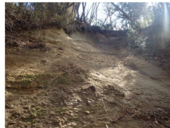
②右岸工事用地下端部の下 溪岸の状況 右岸斜面排水路より排水が行われているが、浸食等は生じていない。オーバーハングで不安定な地形だが前回調査(H28.8.25)から新たな崩壊は発生していない。
