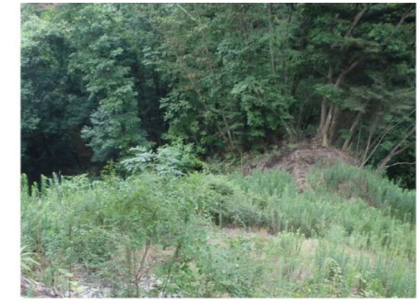
④ 左岸工事用地下端部 前回調査 (H28.3.8) から法面植生工箇所の植生が発達し、溪谷への土砂流出を防止している。
