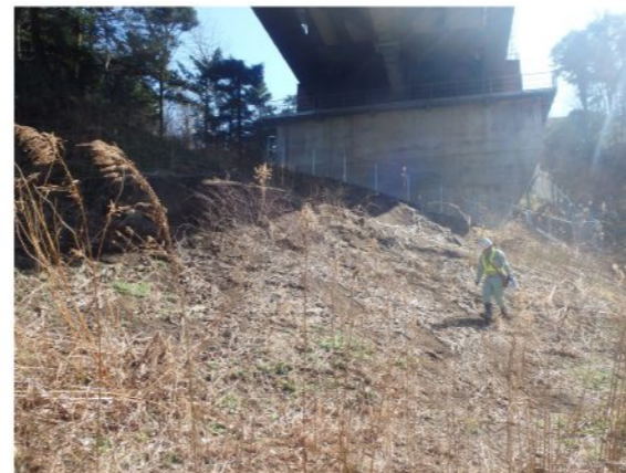
③右岸橋脚前面の状況 法面植生工箇所の植生が発達し、溪谷への土砂流出を防止している。但し、橋脚直下は、急傾斜地のため、周辺の法面と比べて植生の発達が遅い。(前回調査 H28.8.25 から変化無し)
