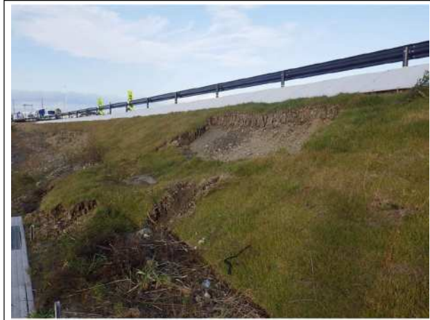
法面の表土流出状況（令和元年10月15日撮影）
