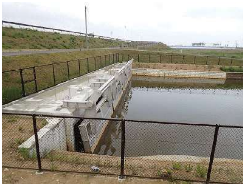
写真 2-1 フラップゲートの設置状況（二郷堀）
