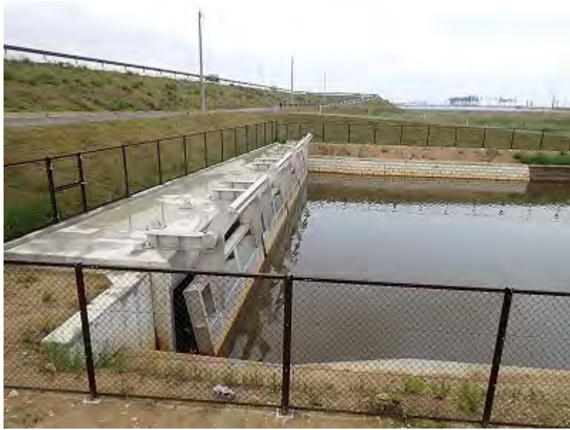
写真 2.5-1 フラップゲートの設置状況（二郷堀）
