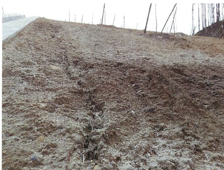
写真 8-6-2 盛土法面洗掘の状況 (平成 25 年 4 月 16 日撮影)
