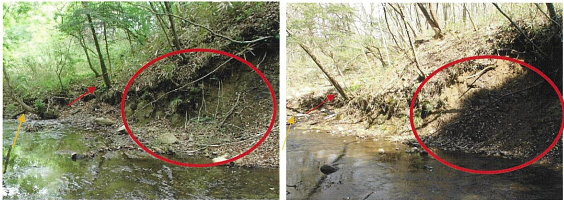
写真 8-2-12 洗掘の状況：平成 25 年（左）、令和 4 年度（右）
