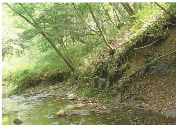
写真 8-2-3 調査地点 1 の上流の洗掘状況：令和 3 年 6 月 14 日
