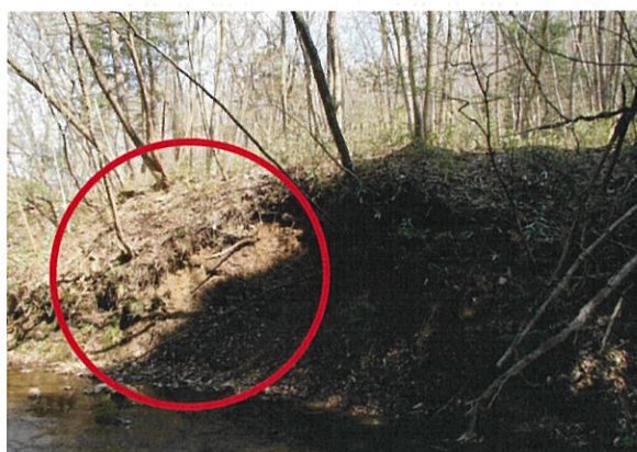
写真 8-2-4 調査地点 1 の上流の洗掘状況：令和 4 年 4 月 20 日
