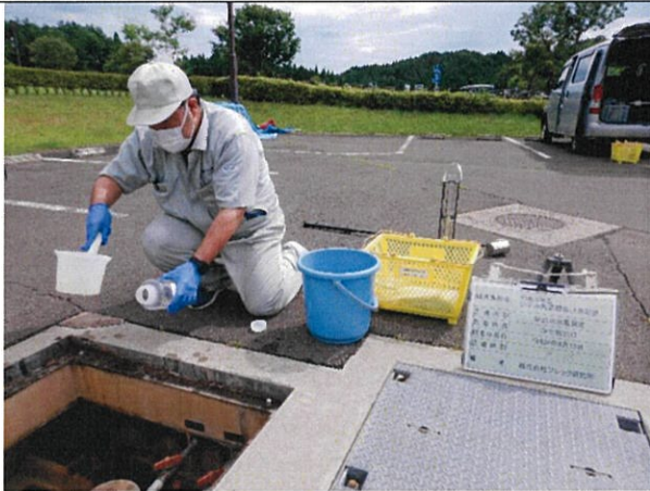
管理事務所浄化槽出口：令和4年8月13日撮影
