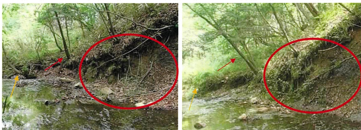
写真 8-3-15 洗堀の状況：平成 25 年（左）、令和 3 年度（右）
