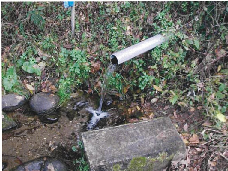
写真 8-1-2 湧水の状況（平成 23 年 10 月 29 日撮影）
