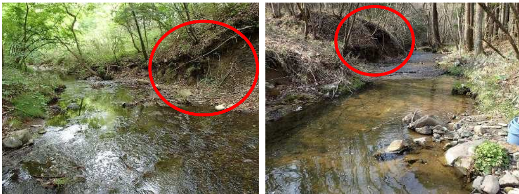
写真 8-4-12 洗堀の状況：平成 25 年（左）、令和 2 年度（右）
