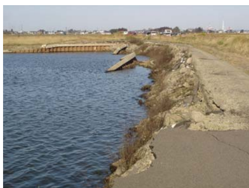
図 5-14 大沼護岸の崩壊状況 (平成23年10月18日撮影)
