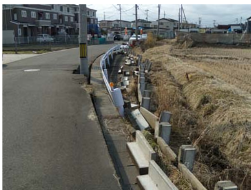
図 5-8 事業区域内農業水路の損壊状況 (荒井地区市道北側) (平成 23 年 3 月 27 日撮影)
