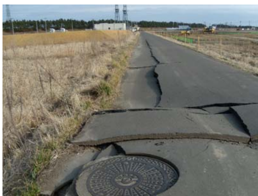
図 5-6 変電所南の道路の損壊状況 (平成 23 年 3 月 27 日撮影)
