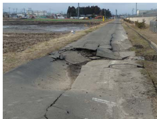
図 5-7 調整池用地の浸水状況 及び道路の損壊状況 (平成 23 年 3 月 27 日撮影)
