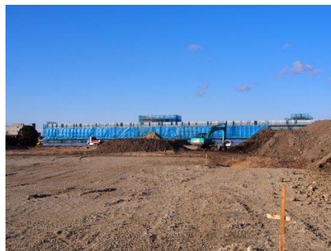
図 4.1-3 地下鉄東西線荒井駅駅舎前 のプレロード転用工事 (平成 26 年 2 月 1 日撮影)
