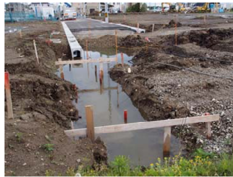
図 5-22 南部造成区域の釜場 (平成 26 年 5 月 22 日撮影)
