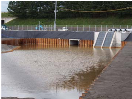
図 5-24 雨水貯留施設 (平成 26 年 5 月 22 日撮影)
