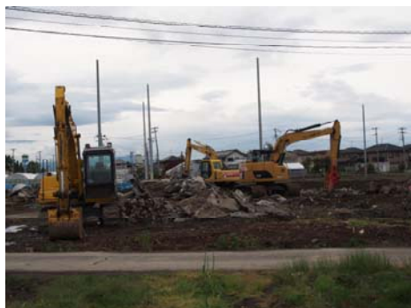
図 5-29 南部造成区域のコンクリート 殻処理状況 (平成 26 年 5 月 22 日撮影)
