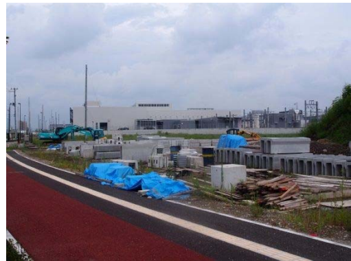
図 4.1-16 地下鉄東西線車両基地の建物隣接街区 （平成 27 年 8 月 12 日撮影）
