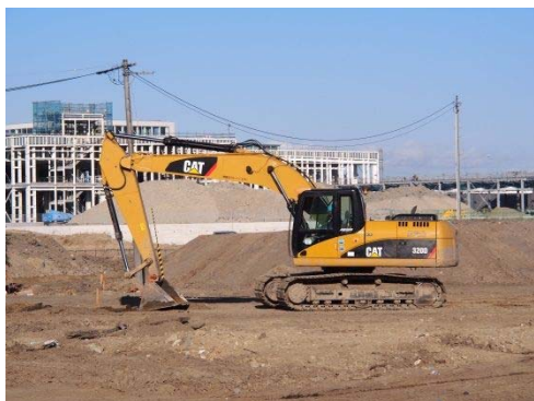
図 4.1-2 地下鉄東西線荒井駅駅舎前 の造成工事 (平成 26 年 2 月 1 日撮影)
