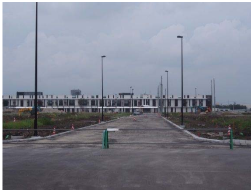
図 4.1-15 都市計画道路荒井駅前線より荒井駅舎 （平成 27 年 8 月 12 日撮影）
