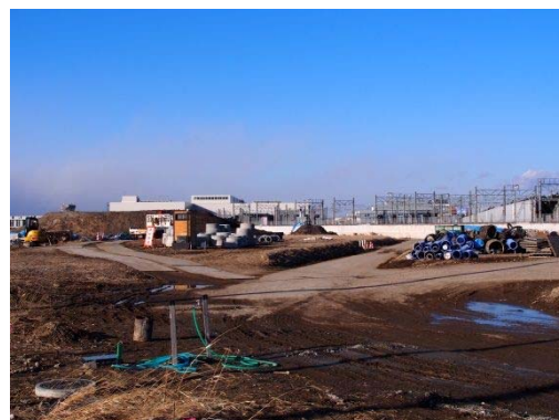
図 4.1-5 地下鉄東西線車両基地 隣接地の埋設管工事の準備状況 (平成 27 年 2 月 10 日撮影)
