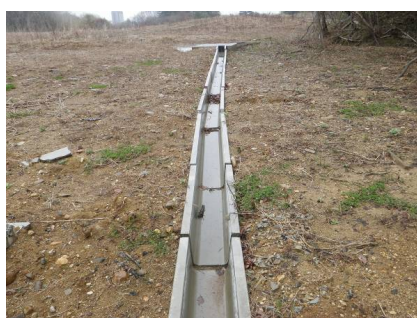
U字溝 (平成 24 年 4 月 27 日撮影)
