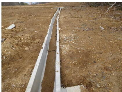
U字溝 (平成 23 年 4 月 20 日撮影)
