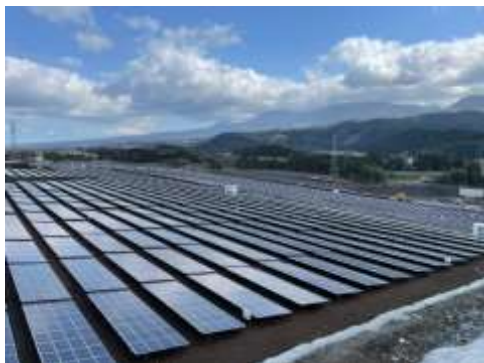
ソーラーパネルの設置状況
