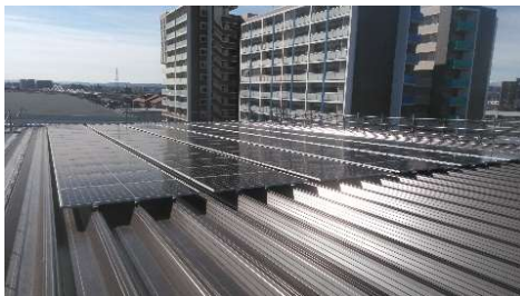
太陽光発電設備
