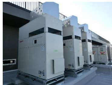
ガスコージェネレーション設備
