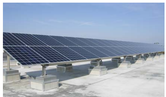
市役所の率先行動 公共施設等への太陽光発電システムの設置（仙台市立旭丘小学校）
