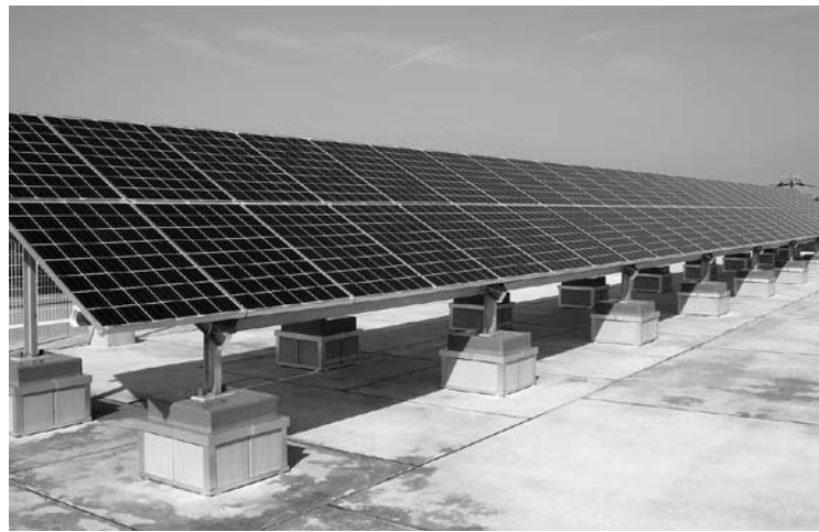
公共施設等への太陽光発電システムの設置（仙台市立旭丘小学校）
