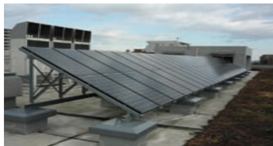
市役所の率先行動 公共施設等への太陽光発電システムの設置（上杉山通小学校）
