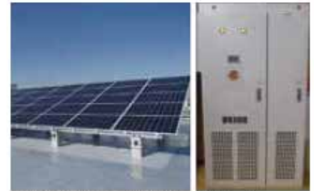
▲指定避難所の太陽光発電パネルとリチウムイオン蓄電池
