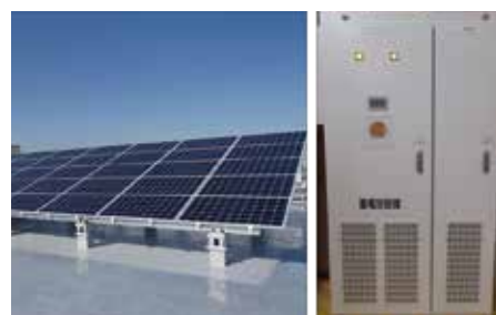
▲指定避難所の太陽光発電パネルとリチウムイオン蓄電池
