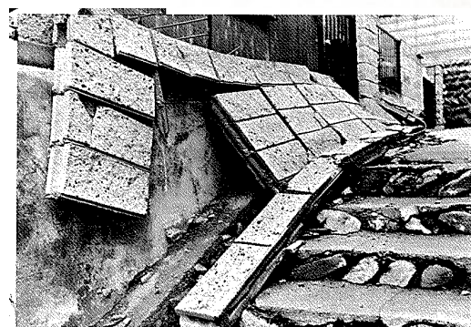
危険なブロック塀等
