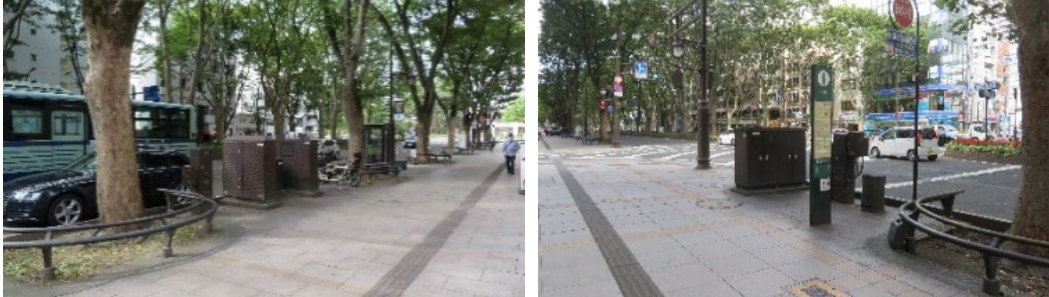
図 地上機器の設置状況
