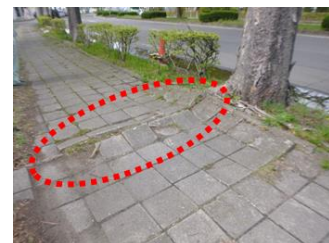
根上がりによる舗装の隆起
