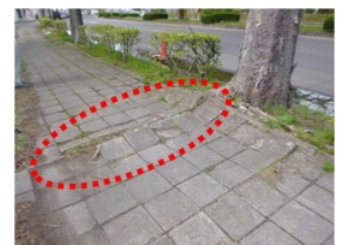
図一〇〇：根上がりによる舗装の隆起
