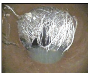
根の侵入による 下水道管の詰まり
