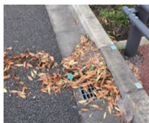
落葉の堆積による 雨水樹の排水阻害
