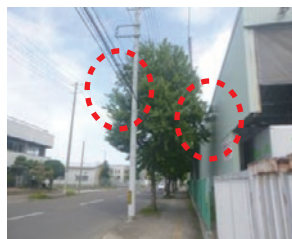
道路空間外への枝の張り出し ・架空線との干渉
