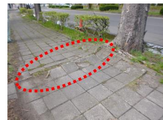
根上がりによる舗装の隆起
