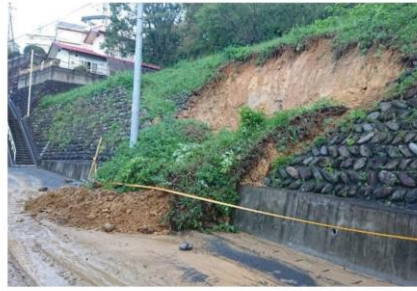
本市における土砂災害（かけ崩れ）の被害 （令和元年東日本台風）
