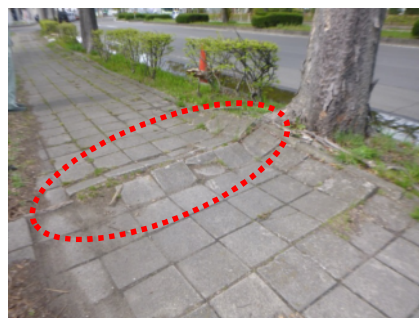
舗装の根上り
