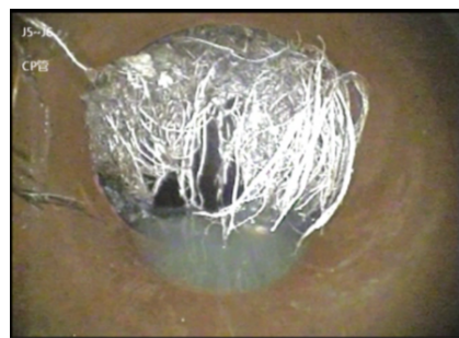
下水道管の根詰まり
