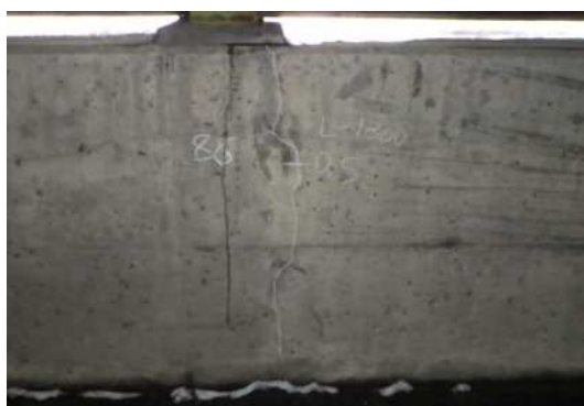
ひび割れ【健全度：Ⅱ】
