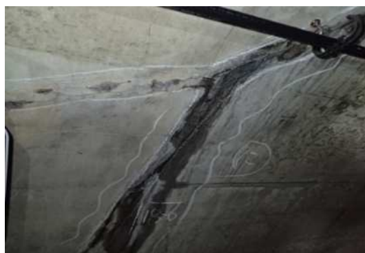
漏水【健全度：Ⅱ】
