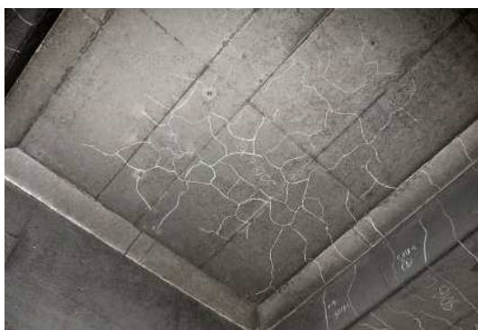
ひび割れ【健全度：Ⅱ】
