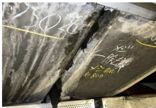
目地材の劣化【健全度：Ⅱ】
