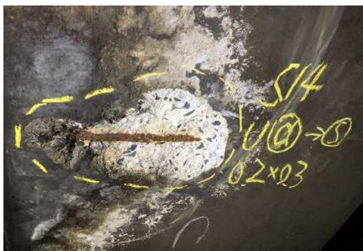
鉄筋露出【健全度：Ⅱ】
