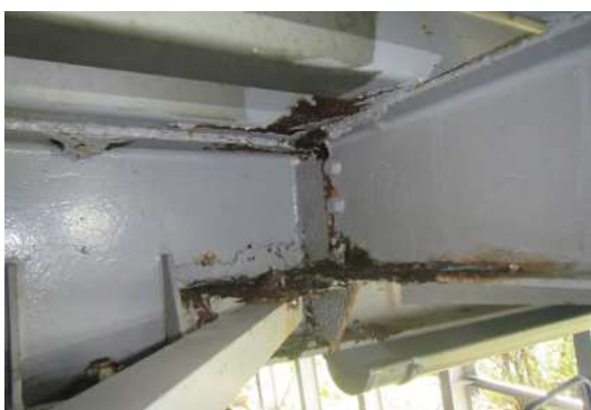
腐食【健全度：Ⅱ】
