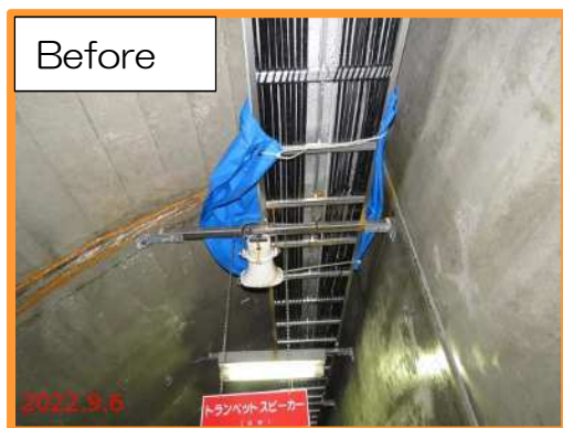
目地開き・段差、漏水
