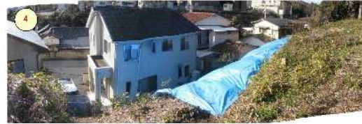
崩壊地頭部から下方を撮影（崩壊箇所には宅地が近接している。）
