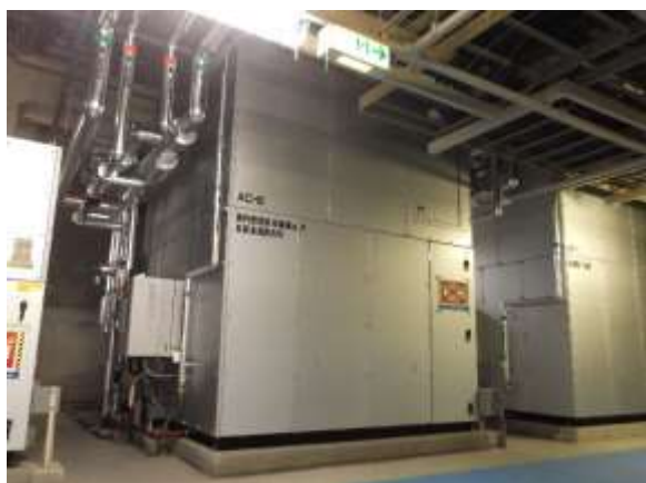
更新後の空気調和設備（一部）
