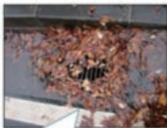
雨水ます上部の詰りにより発生した道路冠水
