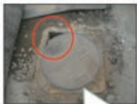
公共ますの受枠が破損している
