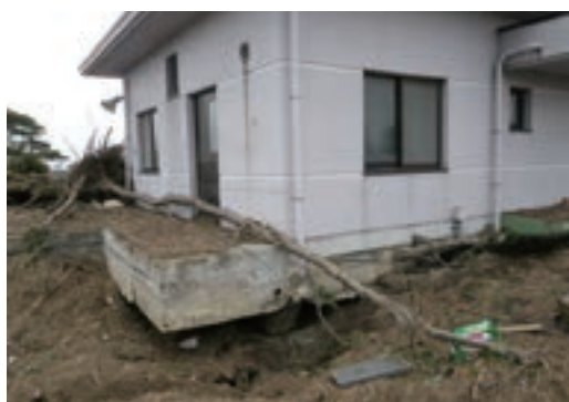
津波で被災した農業集落排水施設
