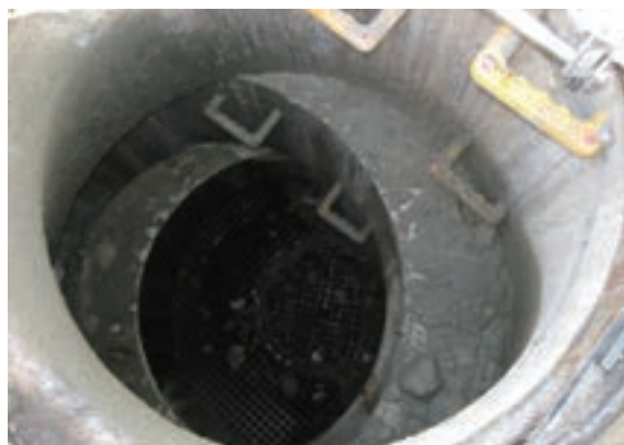
東日本大震災による管路施設の被害
