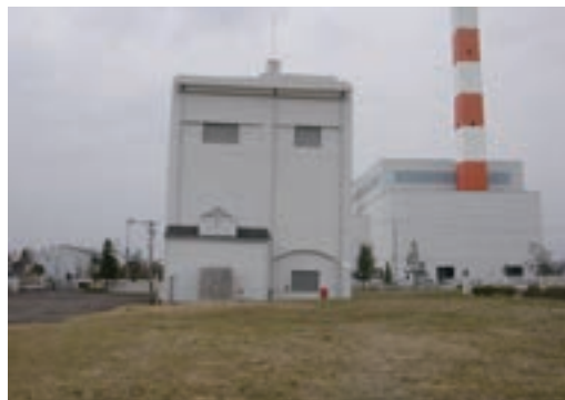
地震により傾いた今泉雨水ポンプ場
