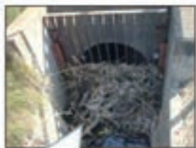
水路やスクリーンが詰り、流れを阻害
