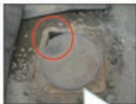
公共ますの受枠が破損している
