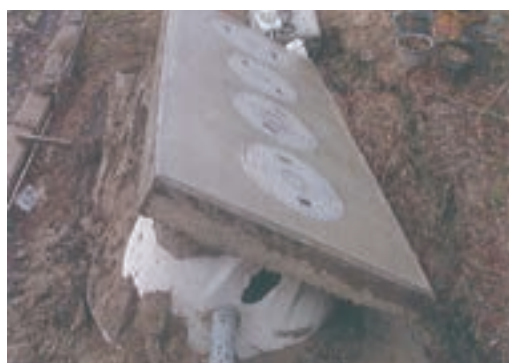
液状化により浮上・転倒した浄化槽
