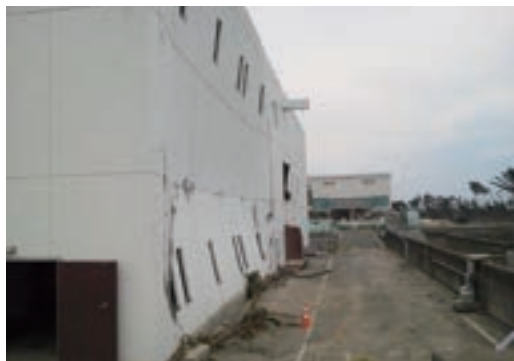
津波で被災した南蒲生浄化センター
