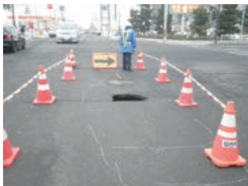
道路陥没の発生 (H25 青葉区南中山)
