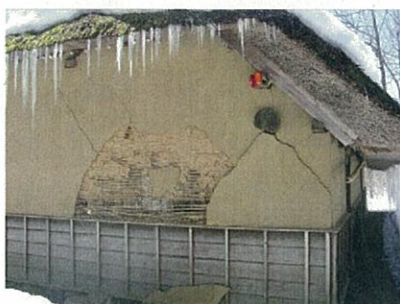
背面側土壁の亀裂と落下
