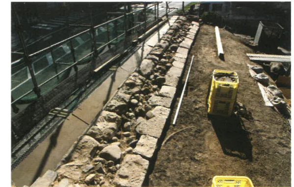
土塀西部の地覆石(東から) 崩壊した部分の地覆石は、北側(写真の右側)の列が沈下し傾いていたため、水平に据え直しました。
