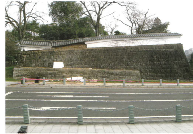
大手門北側土塀の被災状況(南から)
