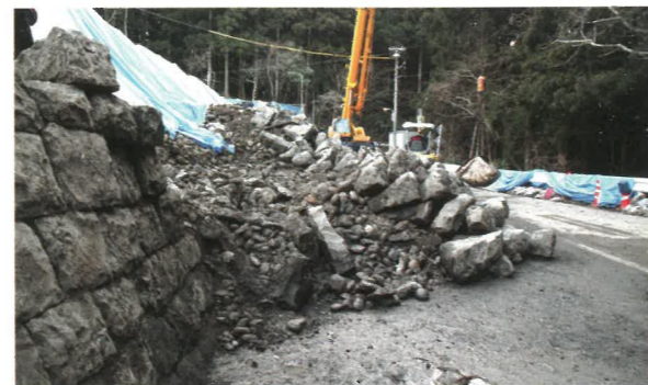
崩れた石のようす 上段の石材
