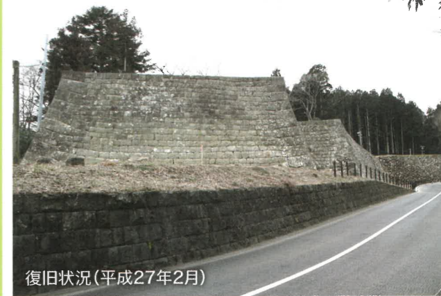
本丸北西石垣北部の被災状況(平成24年11月)
