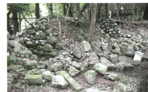
西門石垣の被災状況
