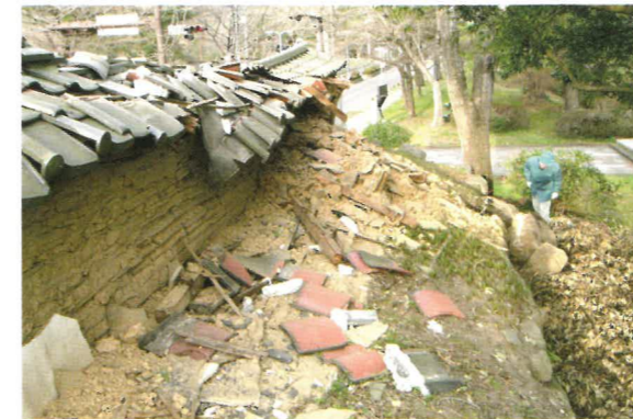
土塀西部の被災状況(東から)
