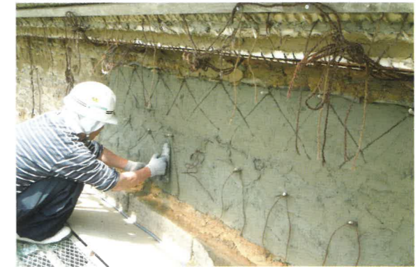
土壁塗り作業 土をはがれにくくするために縄を塗りこんでいます
