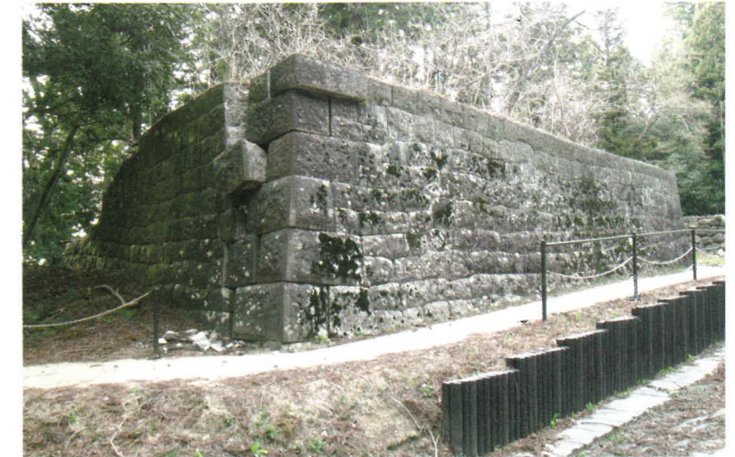
中門北石垣の被災状況 石垣の隅角部が大きくずれ、各面が前に傾いています。
