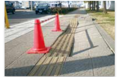
東日本大震災の被災状況
